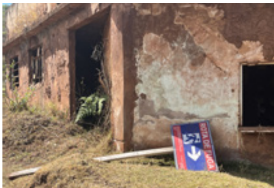
Placa de evacuação caída em Mariana, foto registrada em 27 de Agosto de 2022
