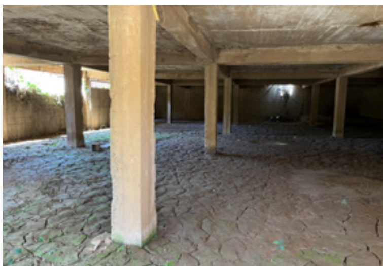
Chão da casa coberto de lama devido à inundação do rio, Brumadinho, foto registrada em 19 de Agosto de 2022
