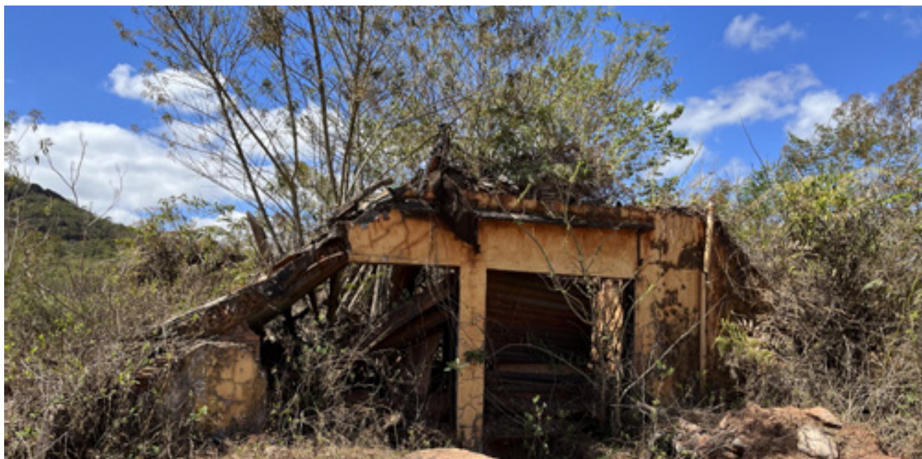
Estrutura destruída pelo rompimento da barragem de rejeitos da Samarco, foto registrada em 27 de Agosto de 2022
