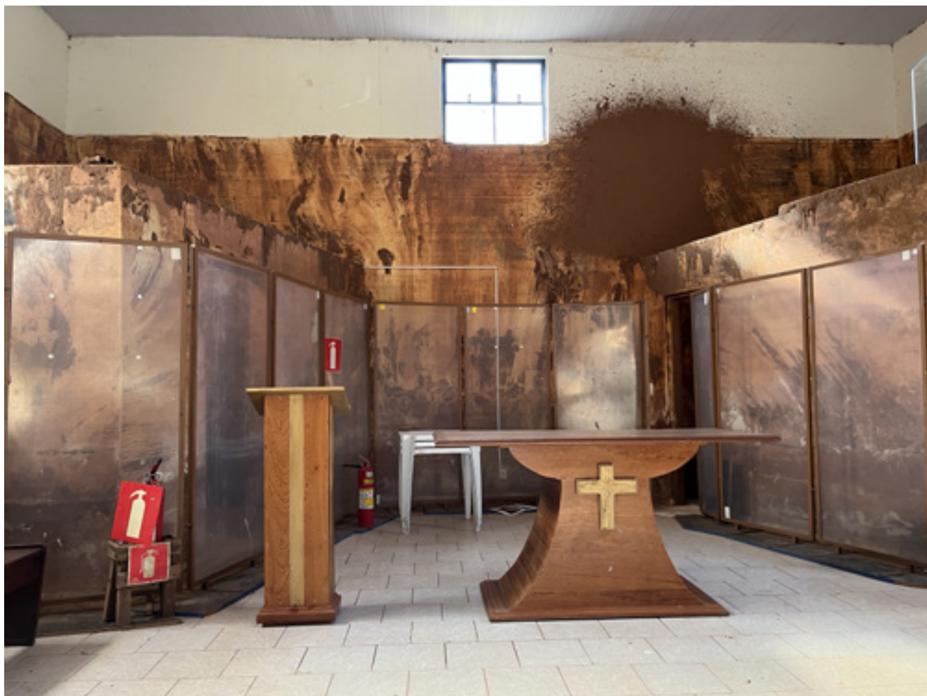
Linha deixada pela lama na parede de uma igreja em Mariana, foto registrada em 25 de Agosto de 2022
